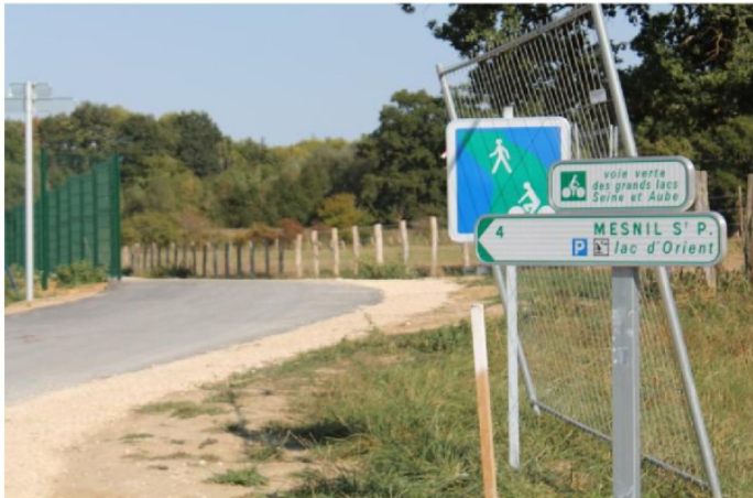
Même si la signalétique est installée, le chantier n'est pas terminé. Il est donc déconseillé d'emprunter le parcours pour le moment.
