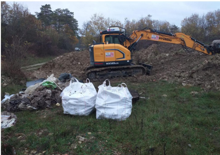
Lors des travaux de dépollution par l'entreprise Masson & Fils. Photo Laurent Guilbaud.
